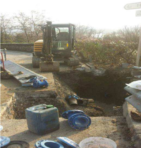
Fuite en cours de réparation.
